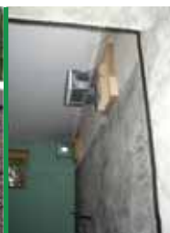
Le bocchette della ventilazione per il ricambio dell'aria
